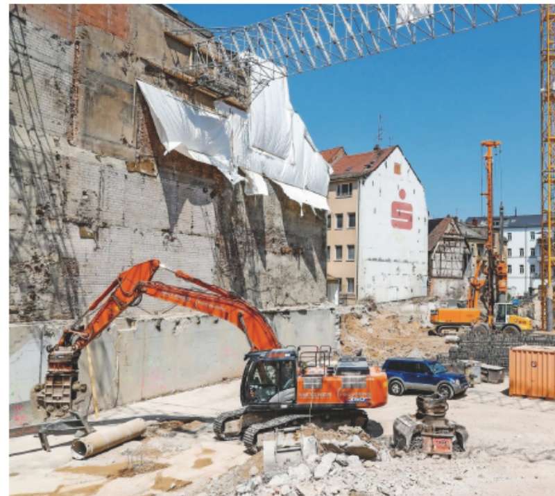
Durchblick von der Langer- bis zur Franz-Ludwig-Straße: Alles ist abgebrochen, der Neubau kann beginnen.
